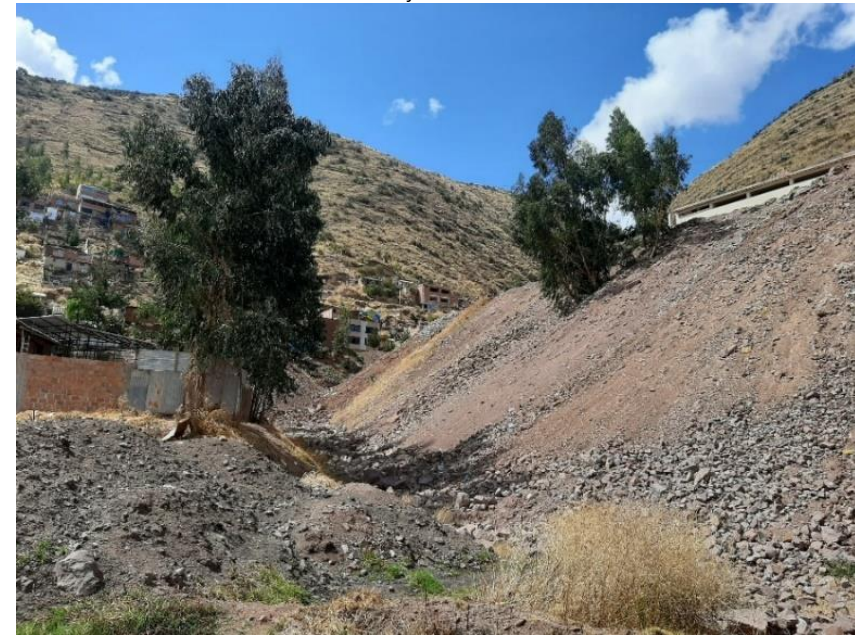
Imagen N° 93: Acumulación de escombros en el área de protección ambiental ubicado en la quebrada Arahuay - Viva el Perú
