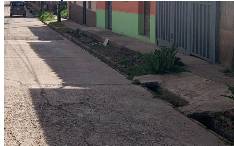
Imagen N° 95: Canal abierto en la Av. Daniel Estrada Pérez
